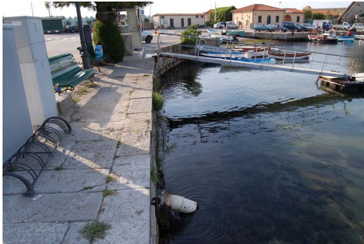
Vista del tubo troppo pieno (in bianco) in corrispondenza del distributore Q8
